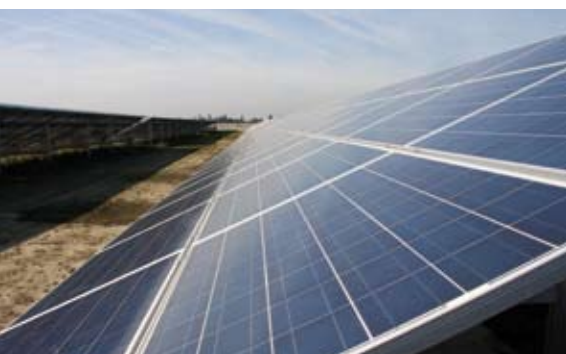
4,7 MW zařízení s REFUSOL 015K (Belgie) 4,7 MW-инсталация с REFUSOL 015K (Белгия)
