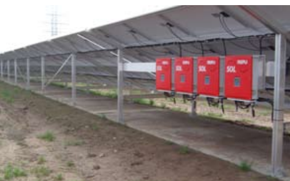
2,2 MW zařízení s REFUSOL 017K (Belgie) 2,2 MW-инсталация с REFUSOL 017K (Белгия)
